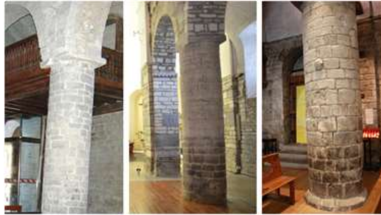
Fig. 13. Pillars leaning; a) Santa Maria d'Arties ; b) Sant Fèlix de Vilàc; c) Era Purification de Bossost.
